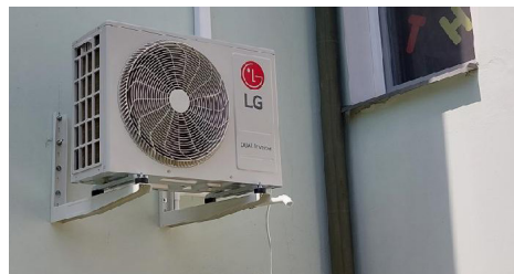
Tepelné čerpadlo pro MŠ v budově OÚ
