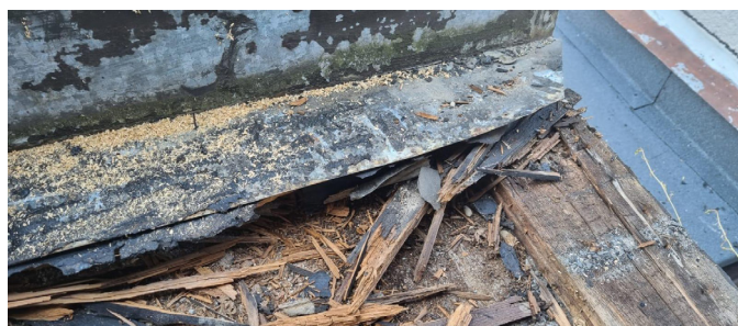
Destruktivní stav střech - detail
